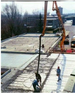
Endschlauch im Einsatz
